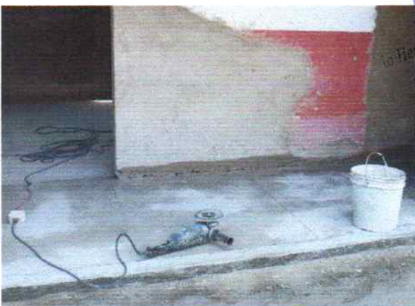
Foto 5 - Visão interna do PSF Campo de Buraco execução do piso em granilite
