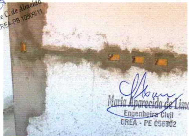
Foto 6 - Visão interna do PSF Campo de Buraco início dos serviços de instalação elétrica, conforme projeto
